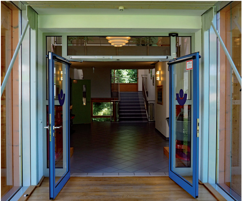
Abb. 12: Zweiflügelige Feuerschutztür mit Rauchsensor und automatischer Türschließung.
