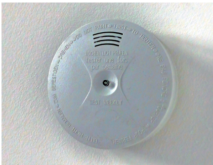
Abb. 11: Herkömmlicher Rauchmelder an der Decke befestigt
