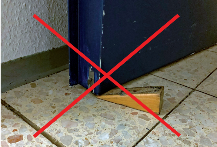
Abb. 13: Verbotenes Verkeilen einer Brandschutztür
