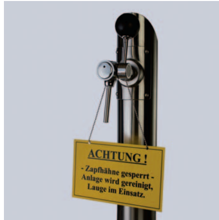
Abb. 8: Warnhinweis am Zapfhahn während der Reinigung
