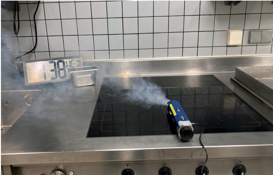
Abb. 13: Falsch: Über der Kochplatte herrscht eine Querströmung, die von der ungeeigneten Zuluftführung verursacht wird
