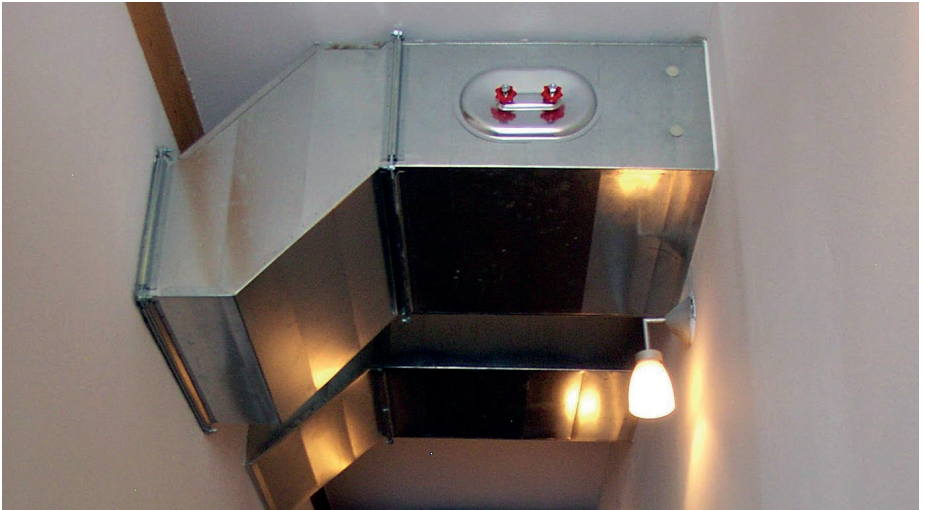
Abb. 23: Luftleitung mit Revisionsöffnung zur Innenkontrolle der Leitung
