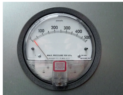
Abb. 25: Manometer zum Ablesen des Differenzdrucks, der am Filter anliegt.
