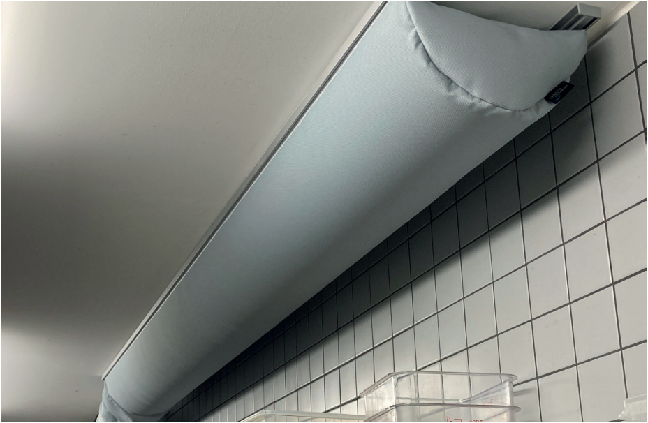
Abb. 21: Textiler Zuluftdurchlass an der Decke
