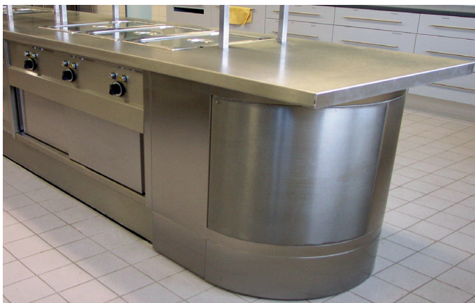
Abb. 15: In das Küchenmöbel integrierter halbzyklindrischer Quellluftdurchlass.
