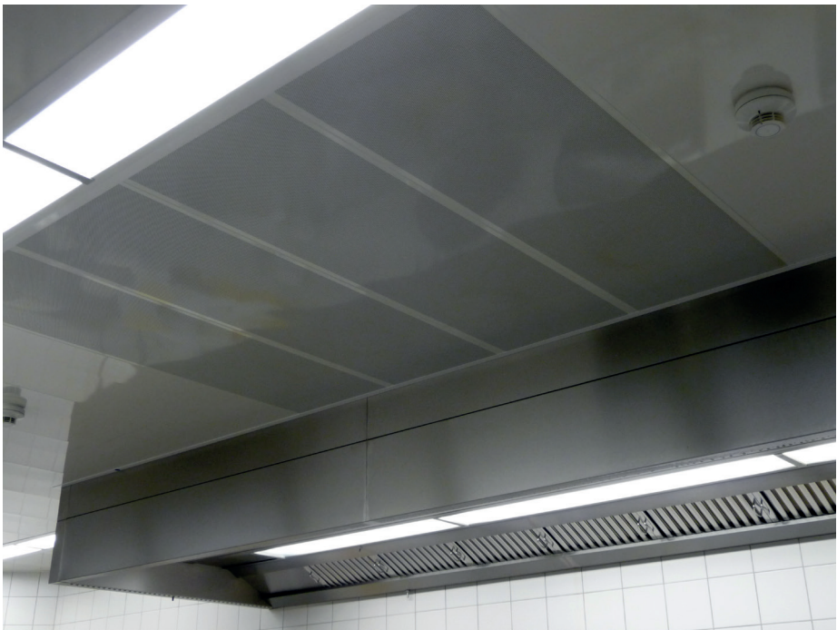
Abb. 18: In die Küchendecke integrierter Verdrängungsluftdurchlass
