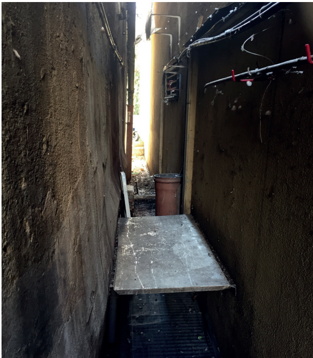
Abb. 24: Starke verschmutzte und hygienisch inakzeptable Situation: Zuluftansaugung im Bodenbereich.
