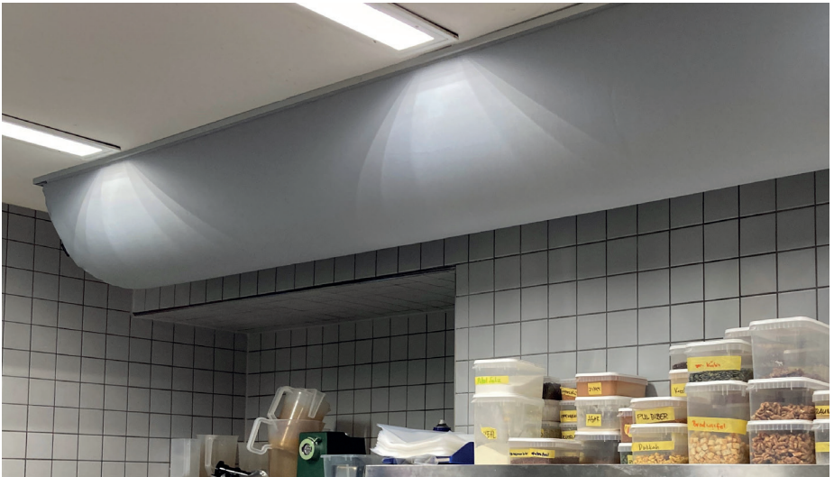
Abb. 20: Deckennaher halbrunder Luftsack zur impulsarmen Lufteinbringung
