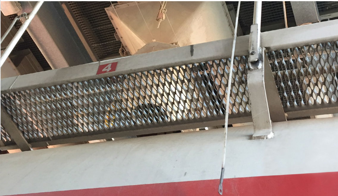
Das Stahlseil war als Knieleiste des aufgestellten Lkw-Geländers angebracht. Es löste sich durch die Wucht des Körperaufpralls aus seiner Befestigung.
