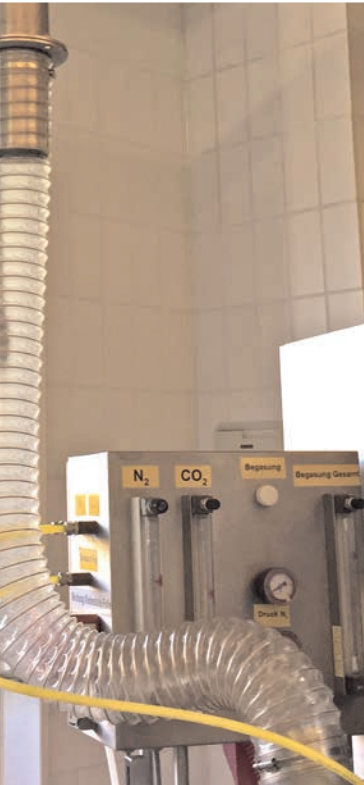
Die flexiblen Absaugschläuche sind an feste Verrohrungen angeschlossen. Durch sie gelangt das abgesaugte Gasgemisch zur Abluftanlage.
